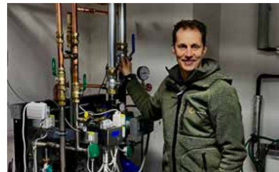
Erik Öhlund som är projektledare och ägare till det lokala fjärrvärmenätet.
